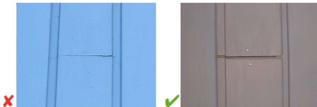
Abbildung 8 - Stumpfstoß falsch montiert (Quelle: Centrum Hout, 2024)
